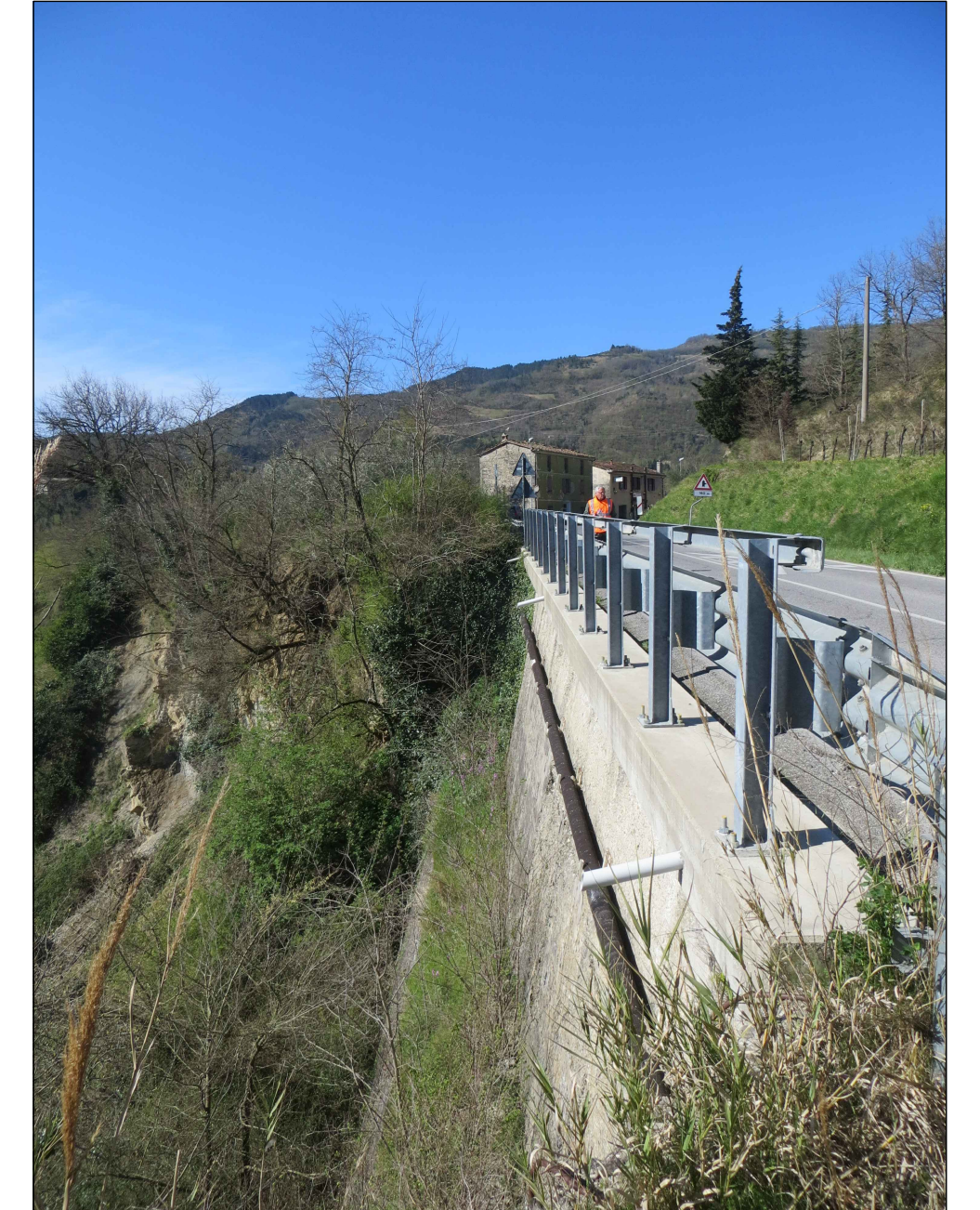
FOTO - Tratto di gasdotto ancorato esternamente al muro esistente
